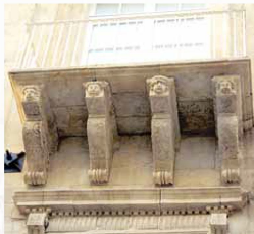
Particolare delle mensole di un balcone
