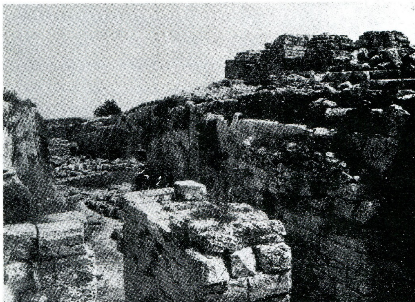
Fig. 33 - Veduta del 3° fossato del Castello Eurialo presa dall'estremità sud vicino ai piloni del ponte levatoio nel quale si rilevano alcuni conci deteriorati.
