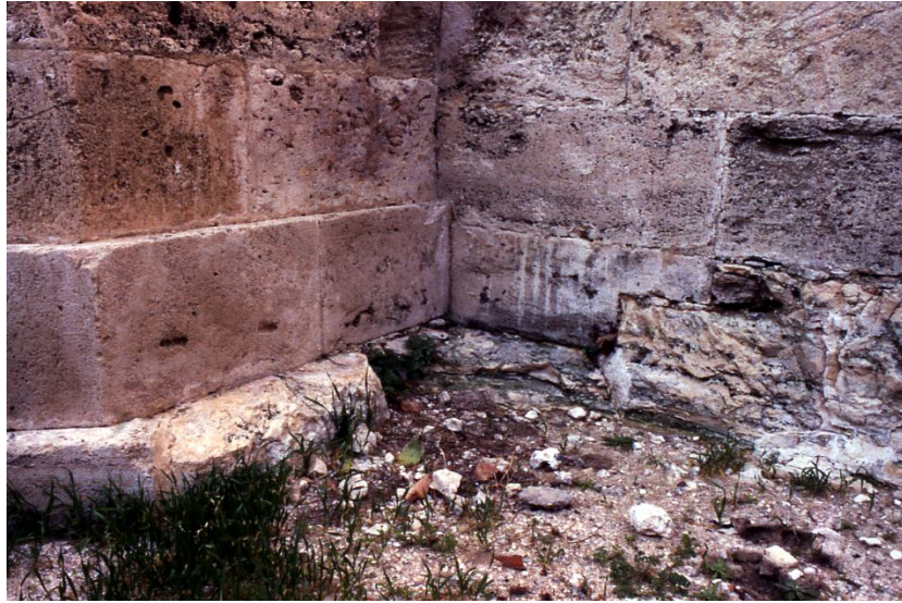
Fig. 02 - Angolo tra la torre Ovest (a sinistra) ed il muro sud-occidentale: si noti lo spianamento del banco di roccia viva quale preparazione per la posa dei grossi conci basamentali del muro da erigere; notare la loro lavorazione e la tecnica di ammassamento nell'angolo.
