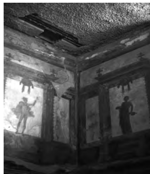
A destra: solaio latero-cementizio a Pompei, dove si manifesta la tipica patologia dello "sfondellamento" (2000).
