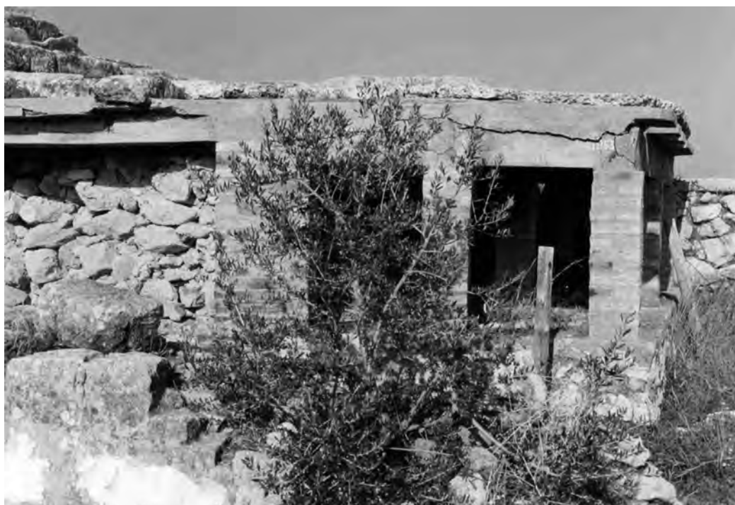
In basso: Solunto: elemento in calcestruzzo di cemento armato, datato 1953, in cui si manifesta uno stato di degrado che compromette palesemente i reperti originari (2001).
