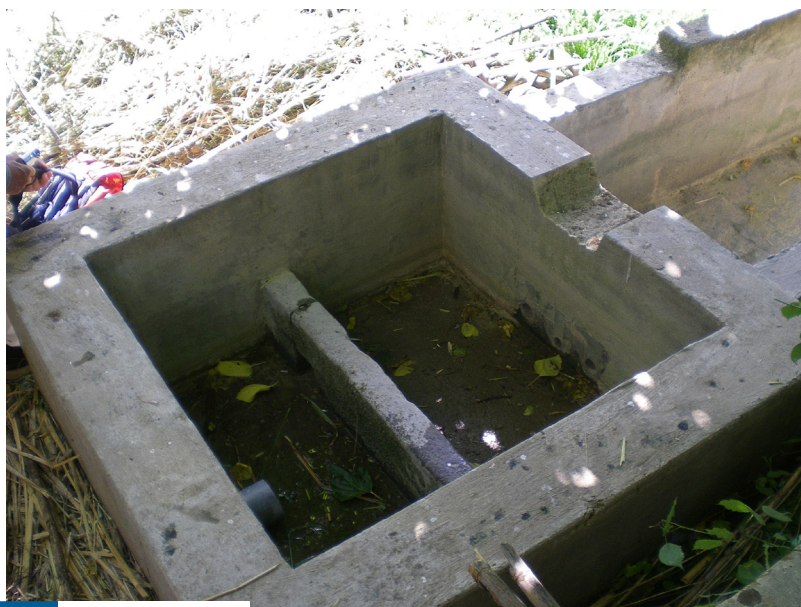
Fig.59 Bassin de régulation
