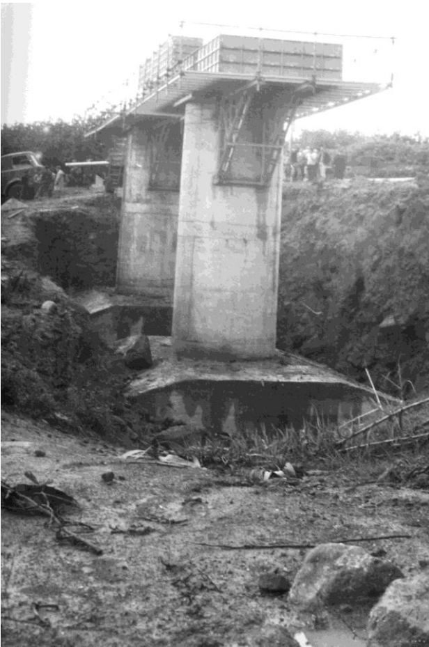
Fig. 8 - Costruzione dell'autostrada Catania-Messina in territorio di Calatabiano, 1969 (Archivio della Soprintendenza di Siracusa).
